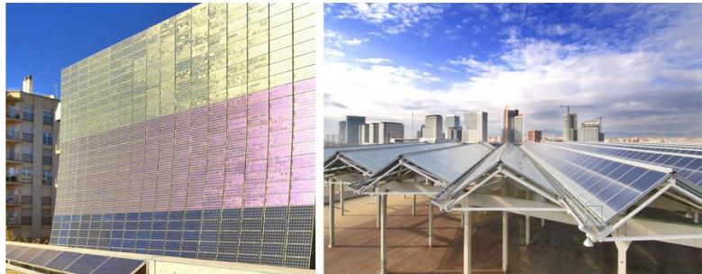
Images courtesy of TFM Energía Solar Fotovoltaica, S.A
